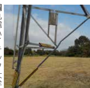
▲破損し曲がった鉄塔
