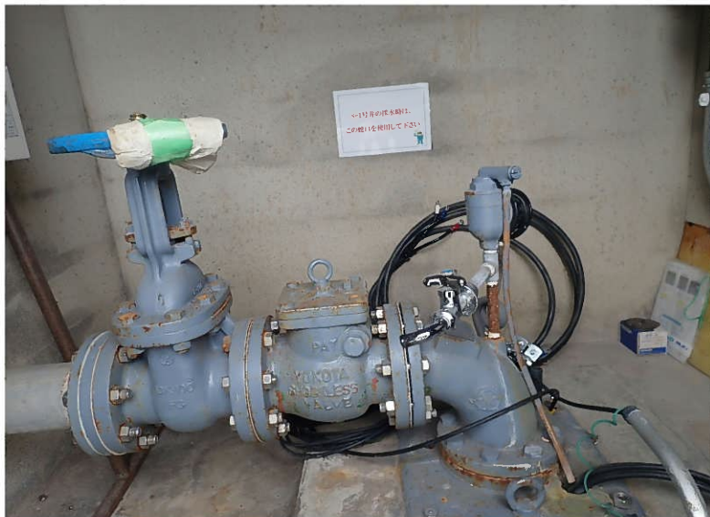
老朽化した8-1号井
