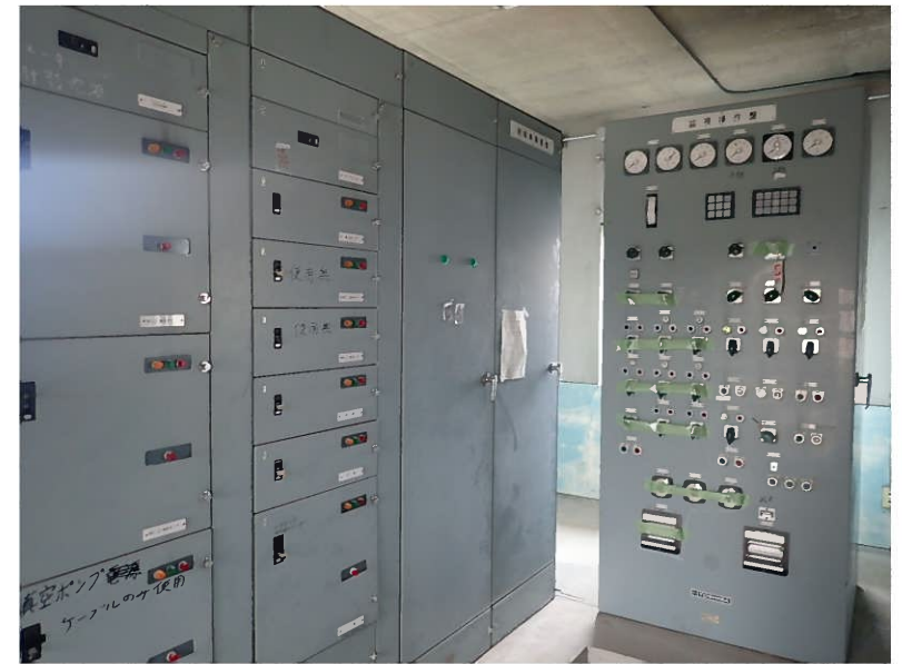
老朽化した八幡台水源地の電気設備
