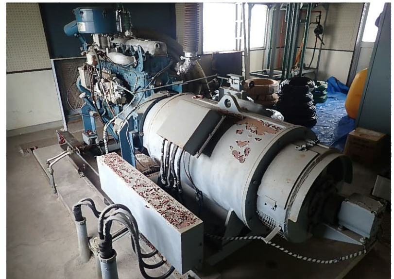
老朽化した八幡台水源地の非常用発電機
