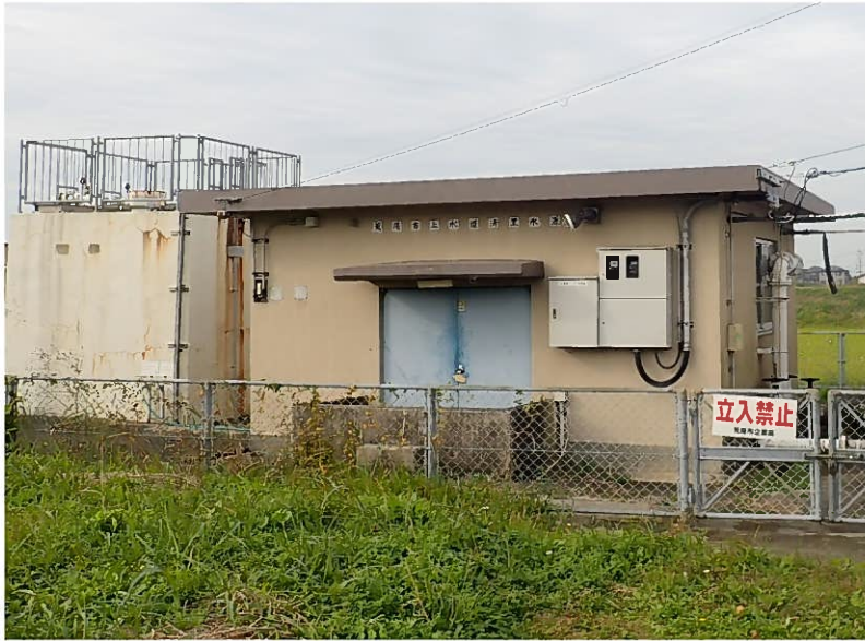
老朽化した清里水源地施設
