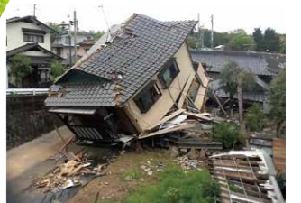
熊本地震 熊本県益城町 【出典: 熊本地震デジタルアーカイブ/ 提供者: 鳥取県東部広域行政管理局 相合消防局】
