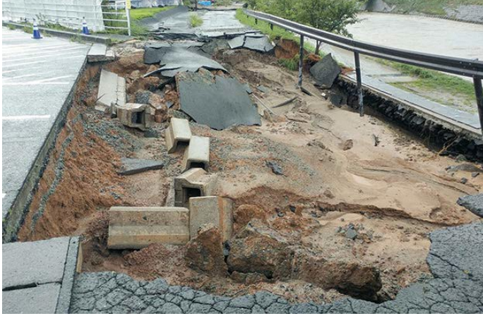
【岩本橋付近道路陥没】
