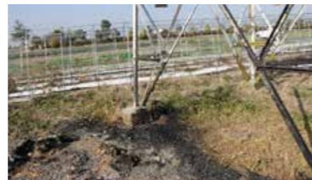
野焼きで焼損した鉄塔
