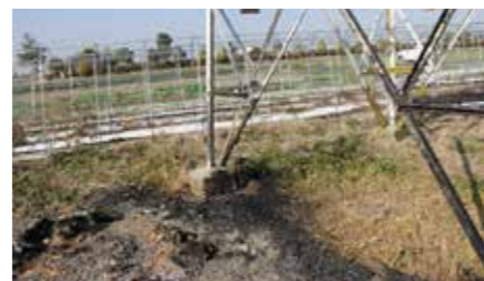
野焼きで焼損した鉄塔
