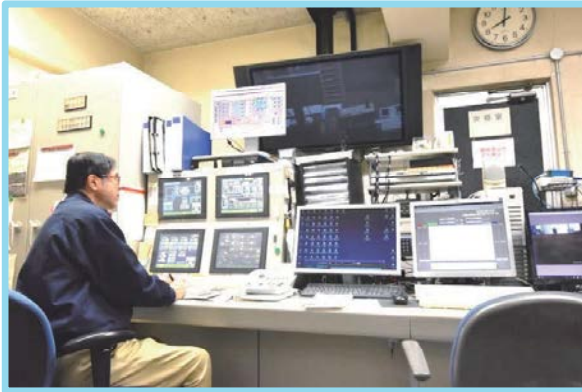
写真 3-7：中央監視室での操作風景
