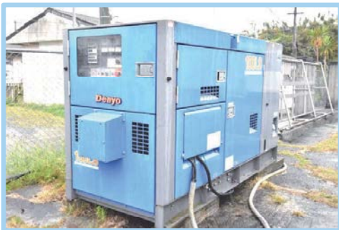
写真 3-5: 桜山水源地の自家用発電機
