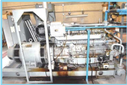
写真 3-4: 中央水源地の自家用発電機
