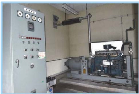
写真 3-6: 八幡台水源地の自家用発電機
