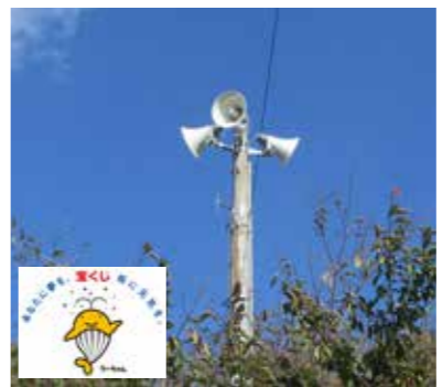
設置された屋外放送設備
