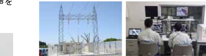
【作った電気を送電します】 【24時間運転監視業務】
