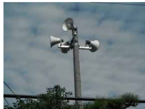
▲市役所敷地内に増設されたスピーカー。
