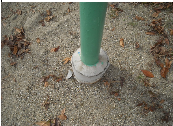
基礎突出状況
