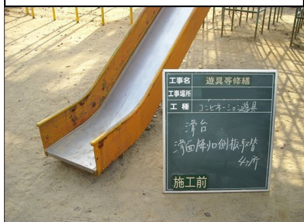
修 繕 前 (滑台側板)
