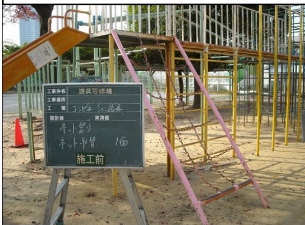
修 繕 前 (チェーンネット)
