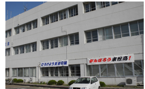
▼東松島市役所は、建物に多少の亀裂が入った程度でした。復興に向けた思いが掲げられています。
