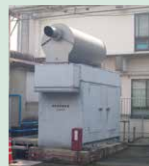
▲非常用自家発電機
