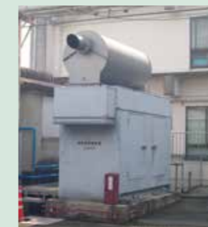
▲非常用自家発電機
