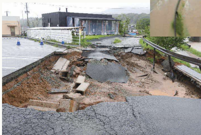
令和2年7月豪雨の影響で陥没した道路(荒尾市)
