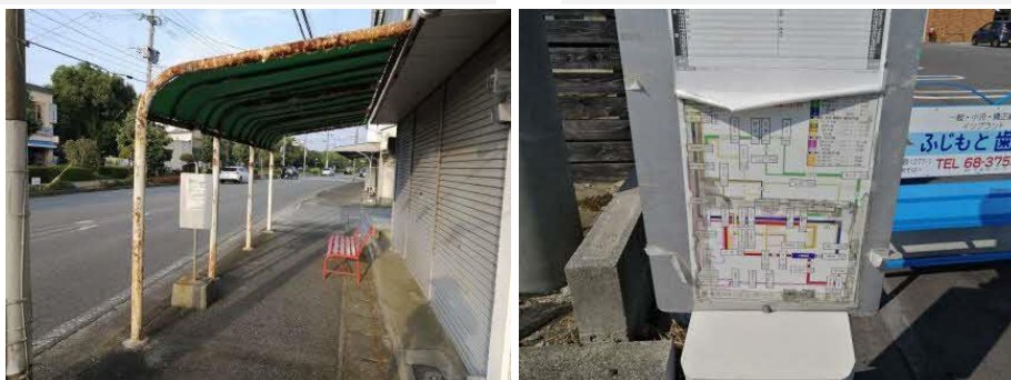
図 4-82 老朽化しているバス停下屋・バス停標柱の整備不良状況
