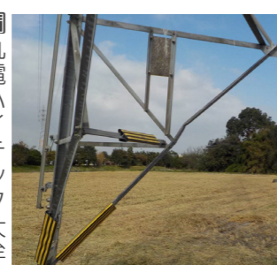
▲破損し曲がった鉄塔
