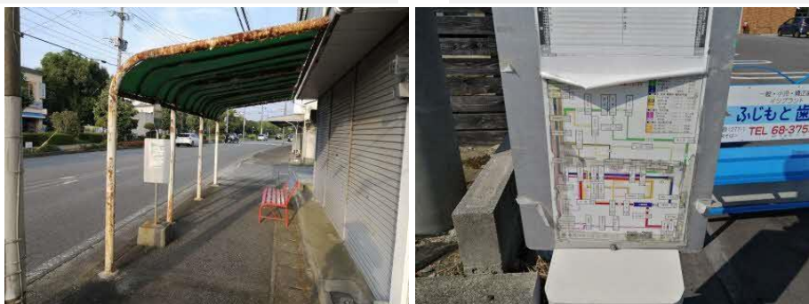
図 4-80 老朽化しているバス停下屋・バス停標柱の整備不良状況
